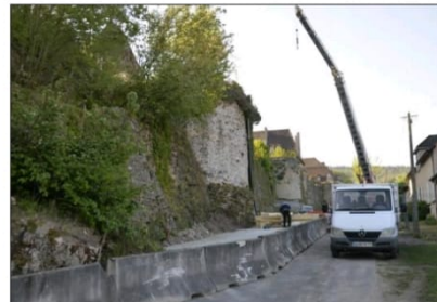
Des travaux de consolidation du rempart ont été entrepris par la Ville après l'effondrement de mars 2020. Photo d'archives JSI/MIG
